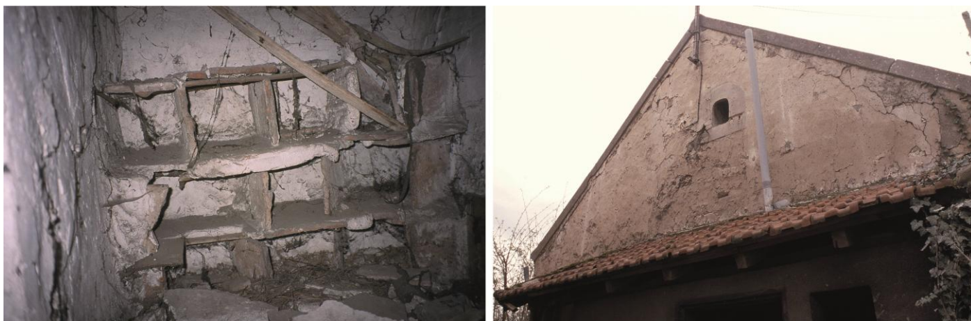
Figure 2. Pigeonnier, entrée et nichoirs du 8bis rue des Fossés (photo Ivan Lafarge, CD93).
