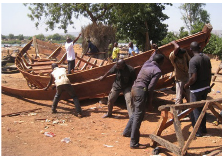
Figure 16. Pose d'un bordé-milieu à franc-bord. Le groupe de compagnons opère sous la direction du charpentier sénior. © P. Féron.
